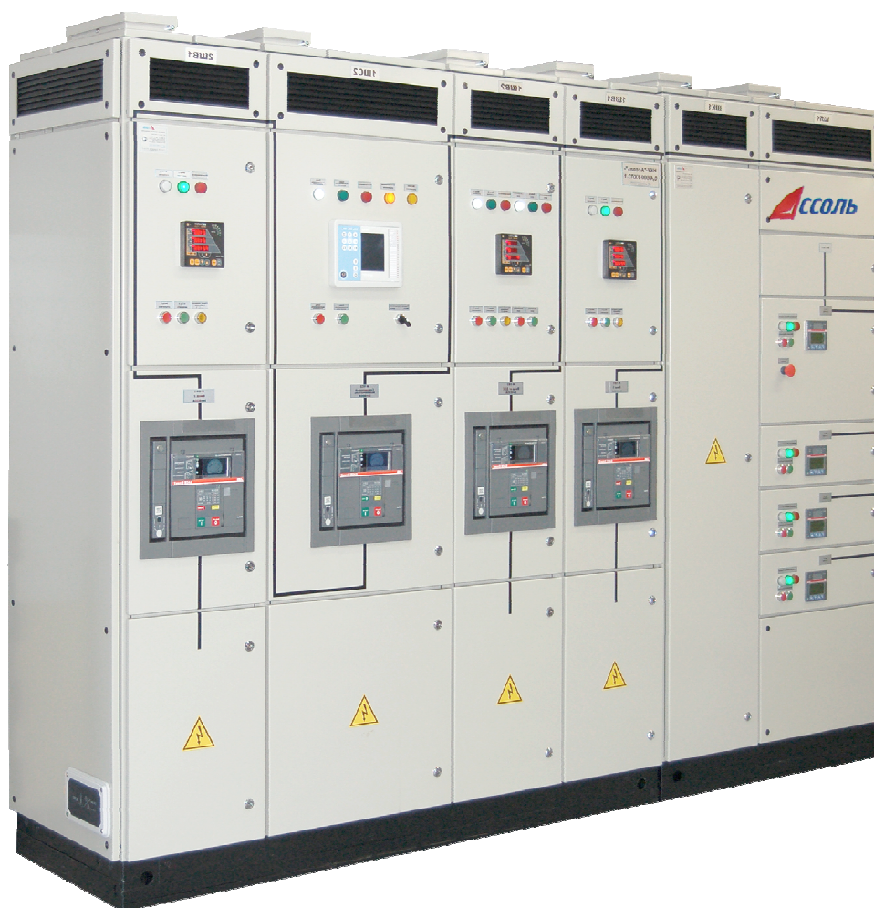
Рис. 2. Внешний вид ЩСН «интеллектуальной» подстанции ЗАО «Электронмаш».
