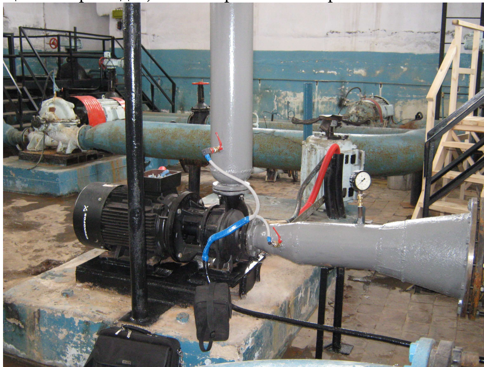
Рис. 2. Насос GRUNDFOS серии NB на станции «Клестовка».
