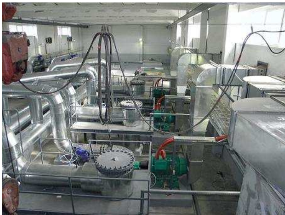
Рис. 2. Перекачивающая насосная станция «Фортум»
