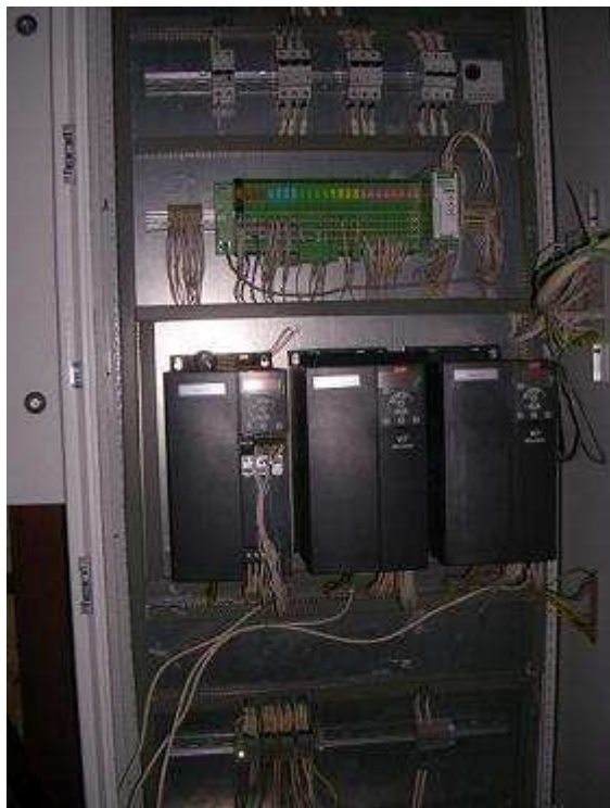
Рис. 3. Преобразователи частоты для управления насосной станцией
