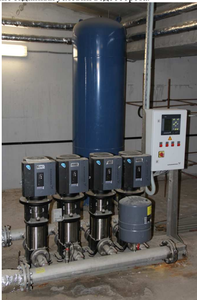
Рис. 5. Установка повышения давления HydroMPC в техническом помещении станции метро «Международная»
