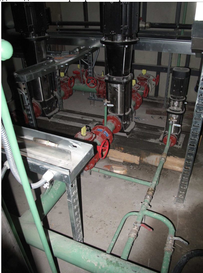
Рис. 4. Техническое помещение насосной станции пожаротушения в ТК «Международный»
