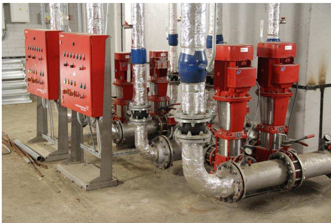
Рис. 3. Установки пожаротушения HydroMX в техническом помещении станции метро «Международная»
